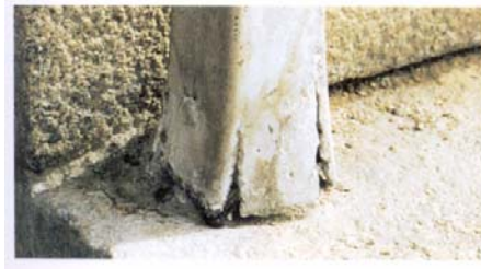
Galvanisk korrosion i detalj till aluminiumräcke efter 25 års bruk. Den fyrkantiga hålprofilen fastsatt på en bult av kolstål. Kontaktytan mellan stål och aluminium har varit fuktig under lång tid. Angreppen har förvärrats av saltning vintertid.
